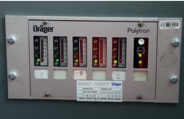
De Dräger Polytron gasdetectiecentrale in de stuurhut
